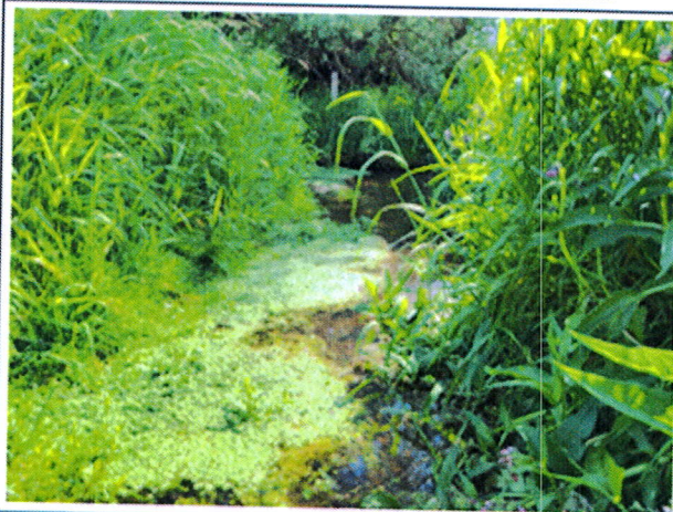
Photo n°5 : vue fin des travaux ruisseau de la Fontaine du Routeux et partie aval ruisseau de la Marguerite
